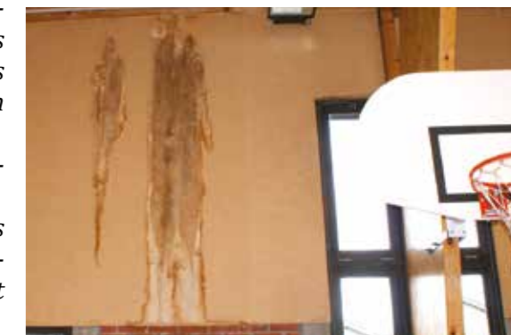
Infiltration d'eau à la salle de sport Pierre Lancelin
