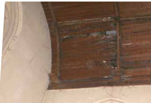
Les boiseries de l'église sont en très mauvais état
